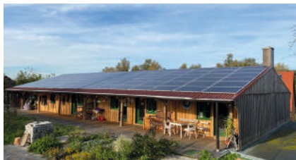
Eine 37 kW-Photovoltaikanlage liefert Strom für 7,3 Cent je Kilowattstunde // Foto: LEKA MV
